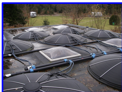
Foto van de ligging van de panelen op het dak van de werkschuur en waserette
